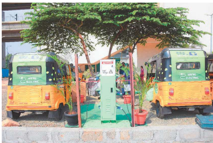
# Stazione di ricarica veicoli elettrici
